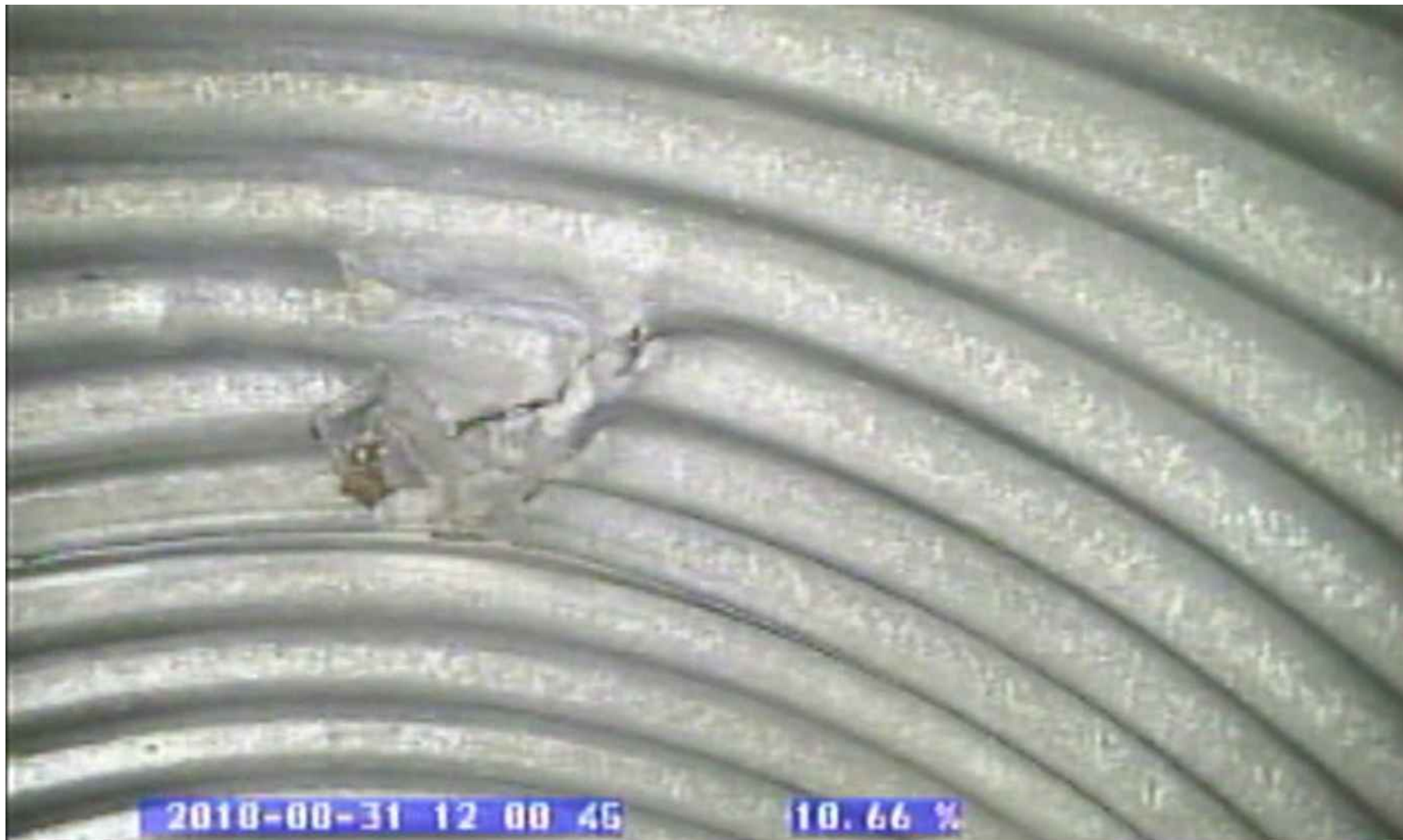
POINT REPAIR STA: 1+00
